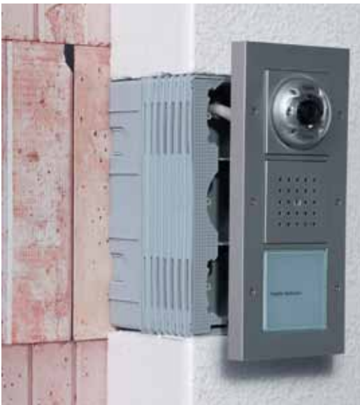
Bild 14: Türkommunikationsanlage an gedämmter Fassade auf Geräteträger montiert
